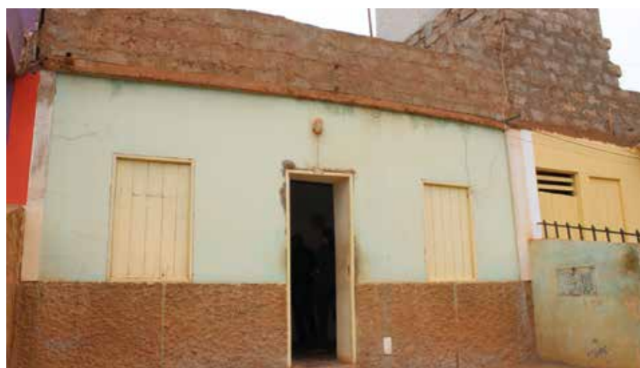
FIGURA 61.3: CONSTRUÇÃO MISTA, INCLUINDO PEDRAS E BLOCOS, ILHA DE SÃO VICENTE. FONTE: ONU-HABITAT
