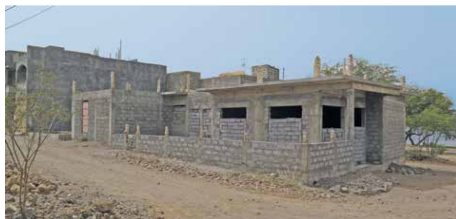
FIGURA 61.2: CONSTRUÇÃO EM ESTRUTURAS DE BETÃO E BLOCOS DE CIMENTO, ILHA DE SANTO ANTÃO. FONTE: ONU-HABITAT
